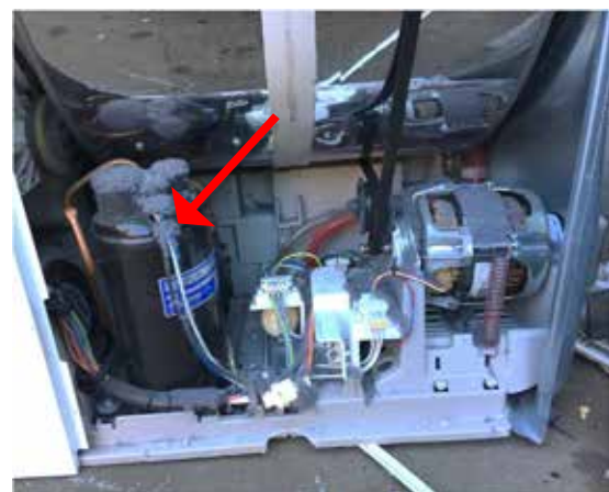
Hinterere Seite, Kompressor sichtbar
